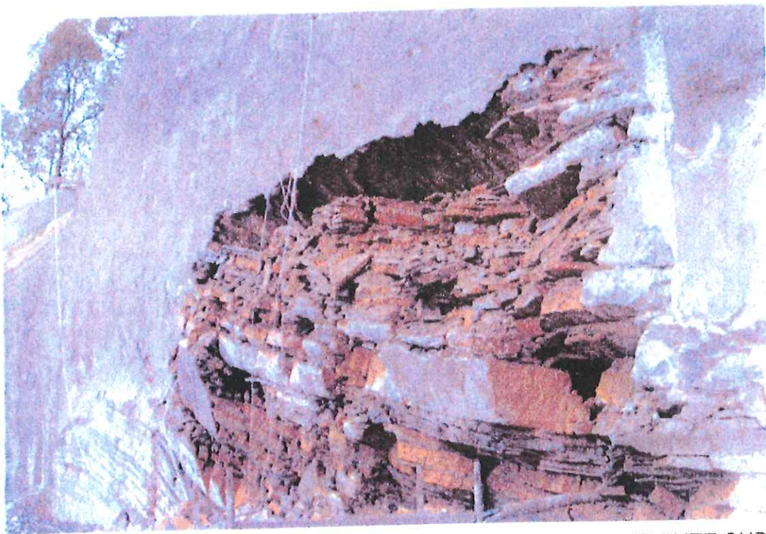
30-12-08 - FRONTE SUD FRANAMENTO STRATO ROCCIOSO
