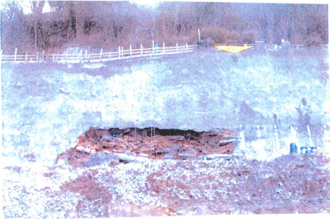
30-12-08 - FRONTE SUD FRANAMENTO STRATO ROCCIOSO
