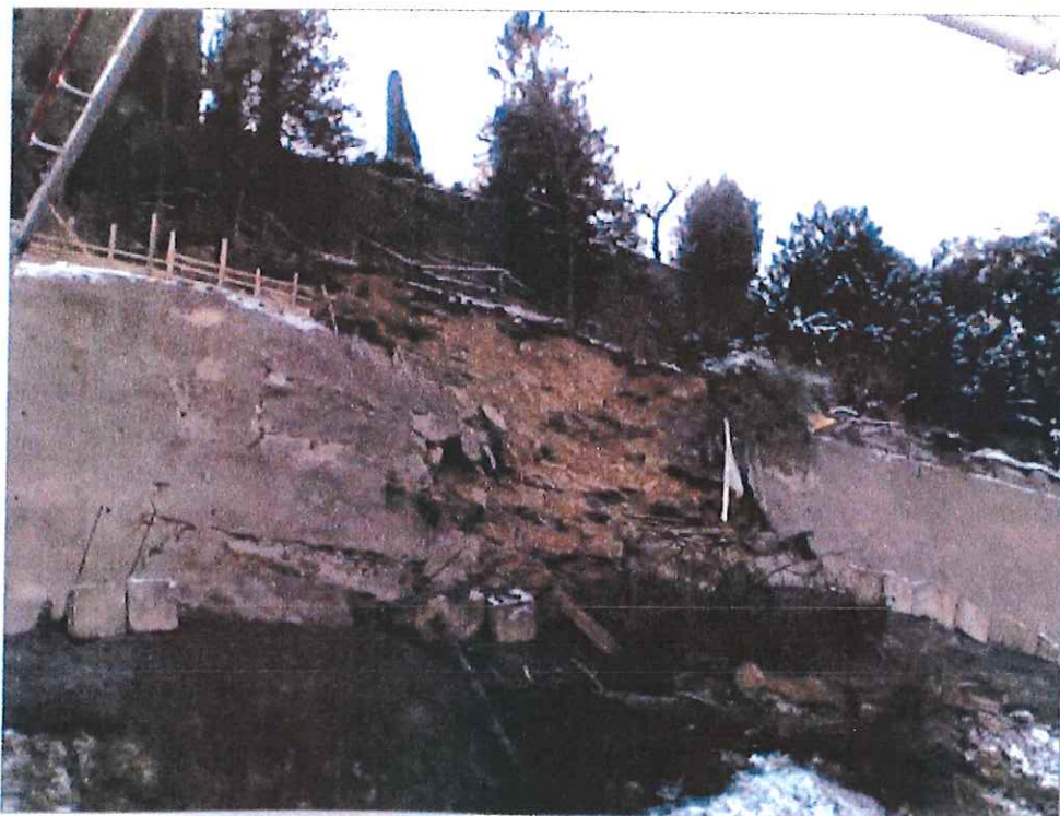
Fig 13- settore centrale del fronte scavo collassato a seguito dell'evento del 02.01.09
